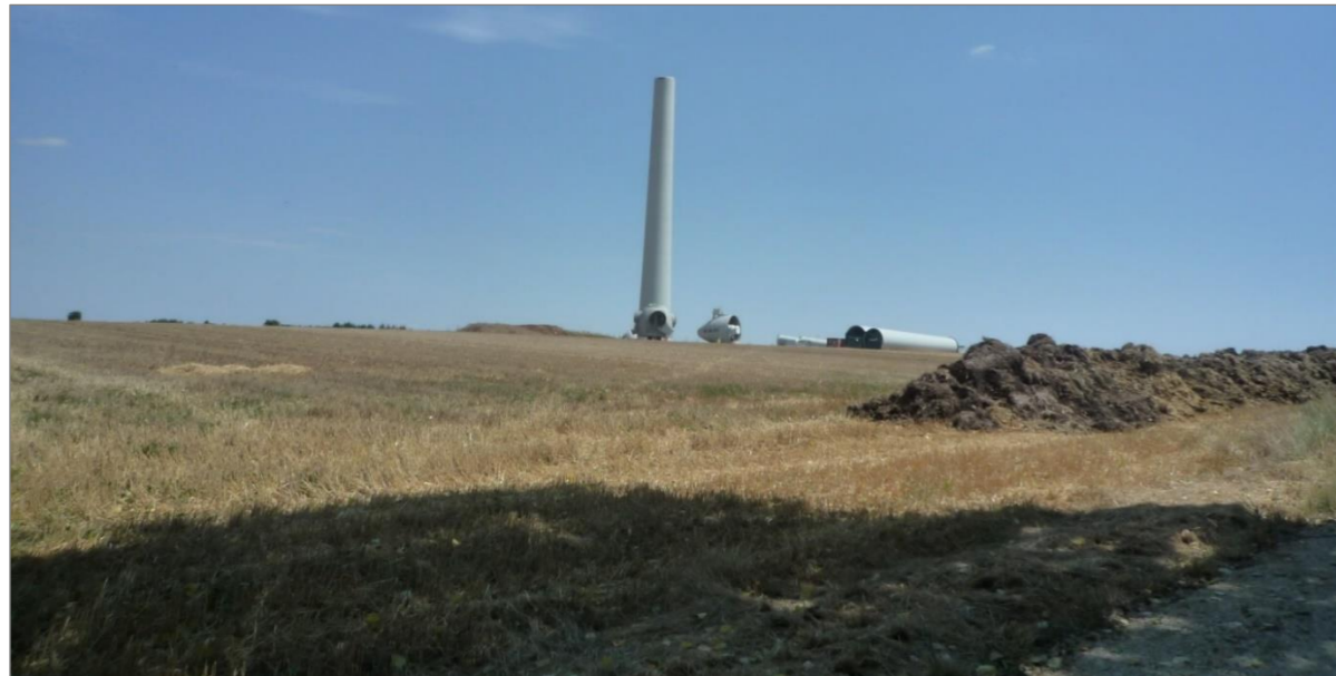
Photographie 42 : Exemple de stockage de terre durant un chantier éolien (Source : ENCIS Environnement)
