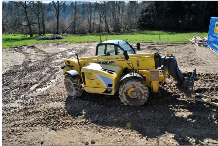
Photographie 41 : Exemple de tassement et d'ornières créés par les engins de chantier
