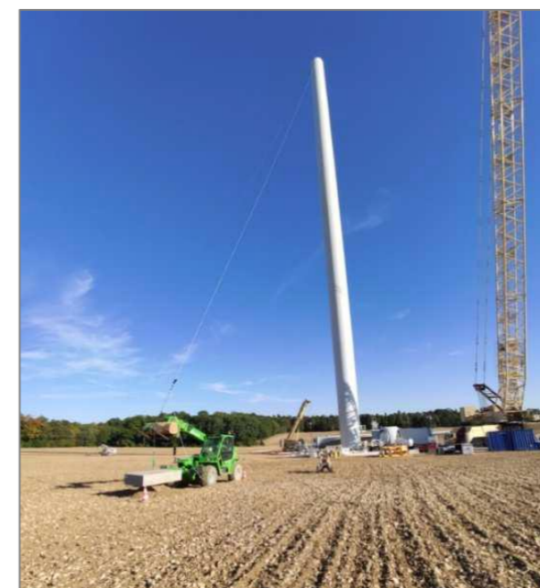
Photographie 29 : Exemple de l'installation de haubans pour stabilisation du mât (Source : RES)
